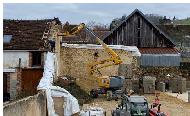
Les rives des toitures voisines sont reprises
